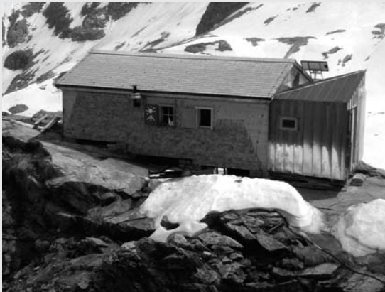
Nagel für Nagel, Hammerschlag um Hammerschlag führen in vielen Stunden zu einer neuen Schindelfassade. Foto: Juli 2005
