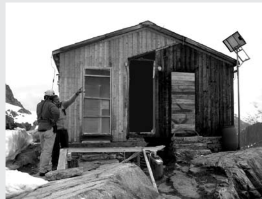
Juni 2005: Die Eternitverkleidung ist abgerissen und entsorgt. Nun erkennt man auch schön die erste Hütte von 1950 (dunkles Holz) mit der ehemaligen Eingangstüre und die Erweiterung vom Jahre 1988.
